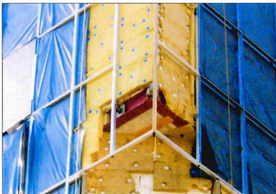
Фото 5. Повреждения минераловатного утеплителя при перерыве монтажа фасада
