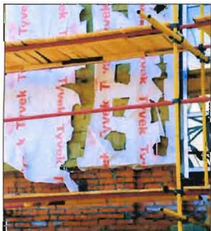
Фото 3. Некачественная установка утеплителя под ветрозащитной пленкой
