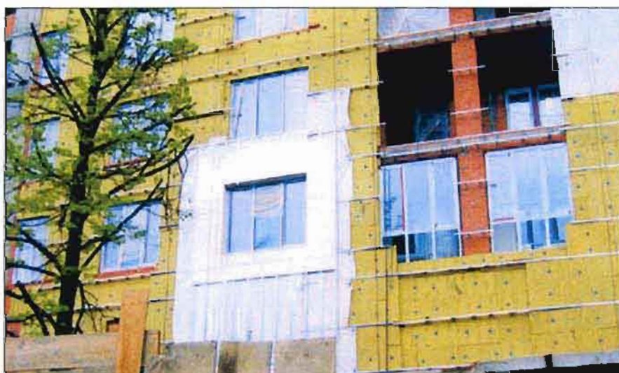
Фото 1. Установка ветрозащитной пленки между направляющими не позволяет получить толщину воздушной прослойки больше толщины вертикальной направляющей — 25 мм
