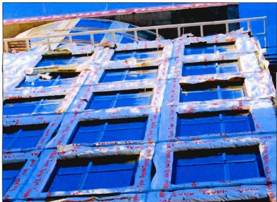
Фото 6. Повреждения ветрозащитной пленки при перерыве в монтаже фасада
